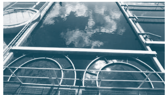
Instalação com dois FlocBees Z4000 operando paralelamente, uma ótima solução para tanques maiores.
