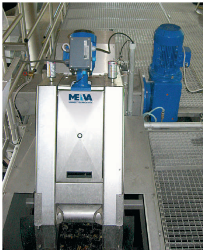
Todos os componentes na unidade compacta de pré-tratamento são feitos em aço inoxidável
