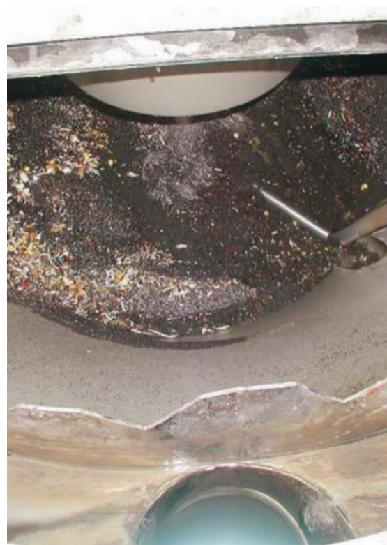
Dentro do Lavador de Areia
